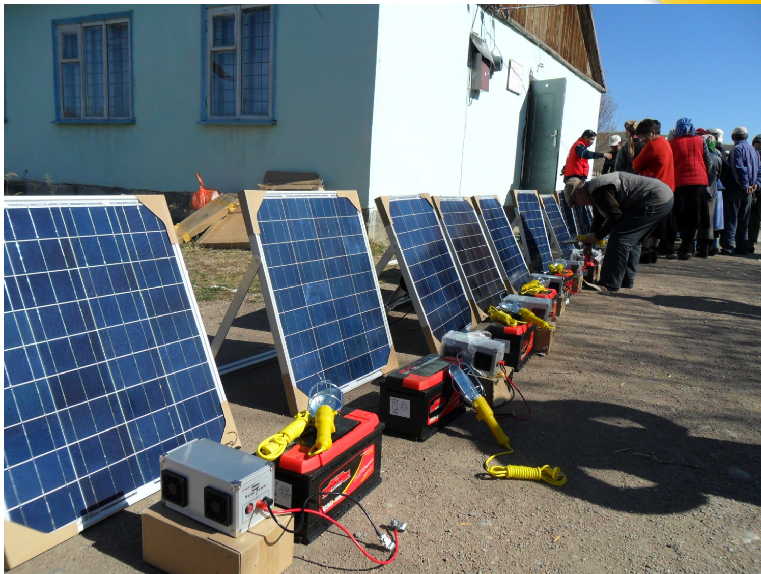
Компактная фотоэлектрическая станция мощностью 100 Вт. Суусамырский район, с. ,Кожомкул
