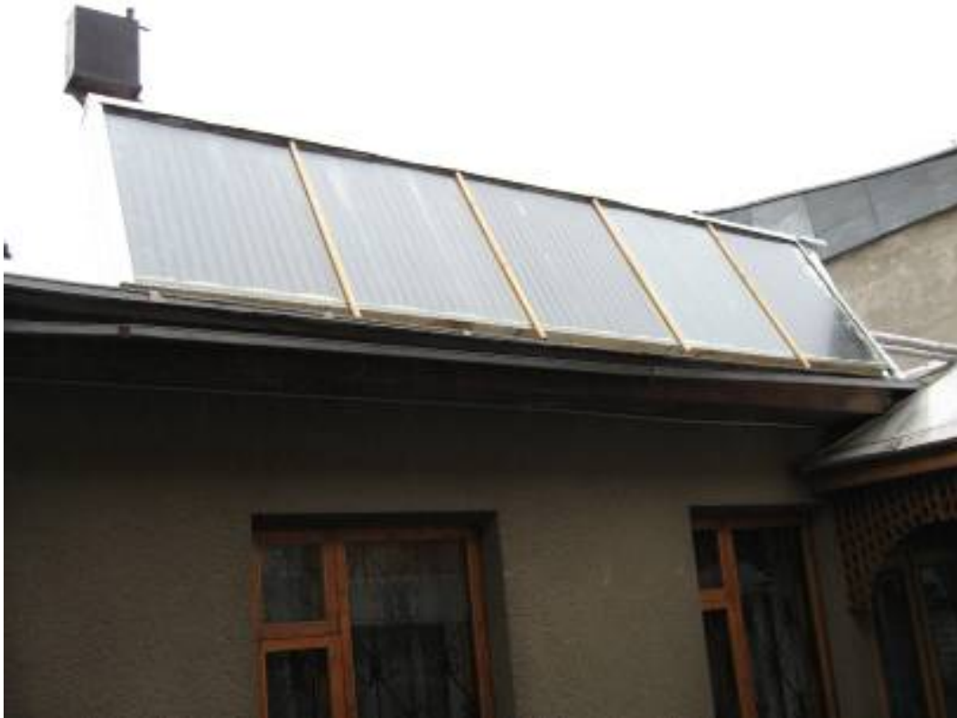
Плоский стальной солнечный коллектор для отопления дома Площадь коллектора 10 кв. м. г. Бишкек
